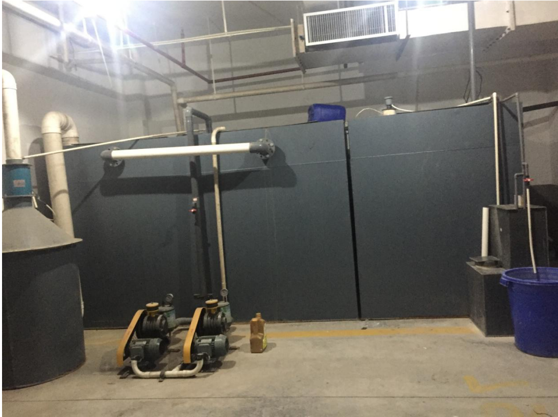
图 4-2 废水治理设施图片
