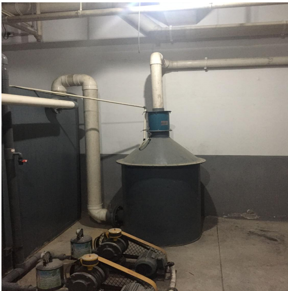
图 4-3 臭气治理设施图片
